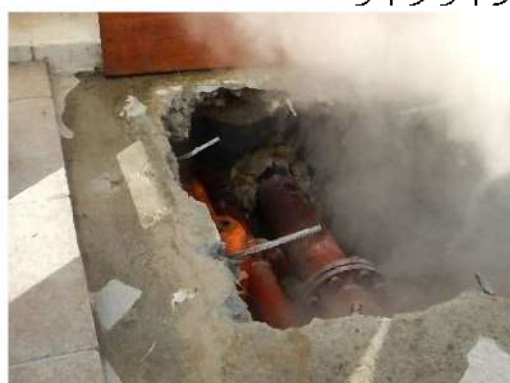
蒸気配管の老朽化
