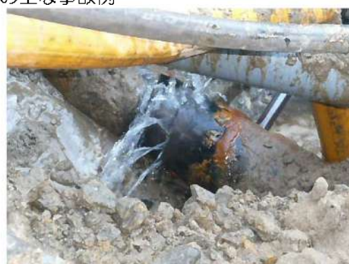
給水管の老朽化
