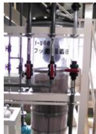
フッ素吸着塔（イオン交換樹脂）
