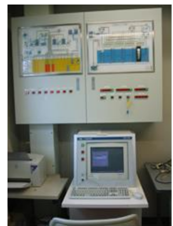
放射能監視システム
