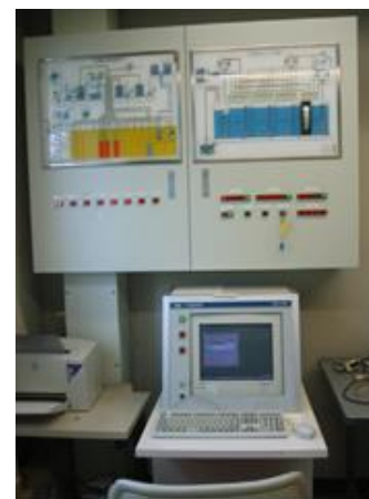
放射能監視システム
