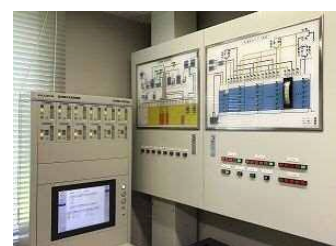
放射線監視システム
