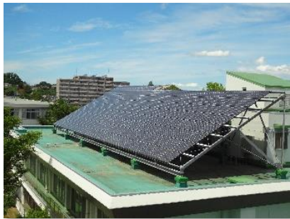
中央図書館屋上に設置されている 太陽光発電設備
